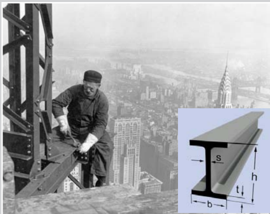
Montage an einem Doppel-T-Träger beim Bau des Empire State Building/ Schema eines solchen Trägers
